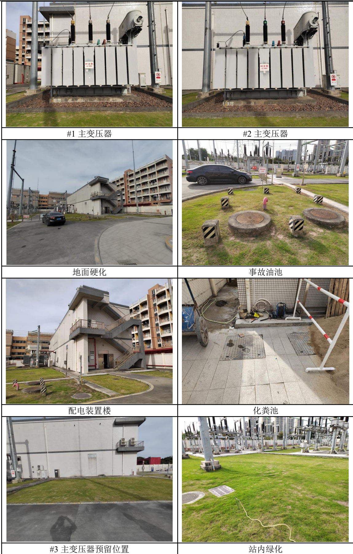
图 3-4 110kV 科苑站现状照片
