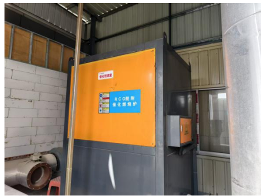
RCO 脱附催化燃烧炉
