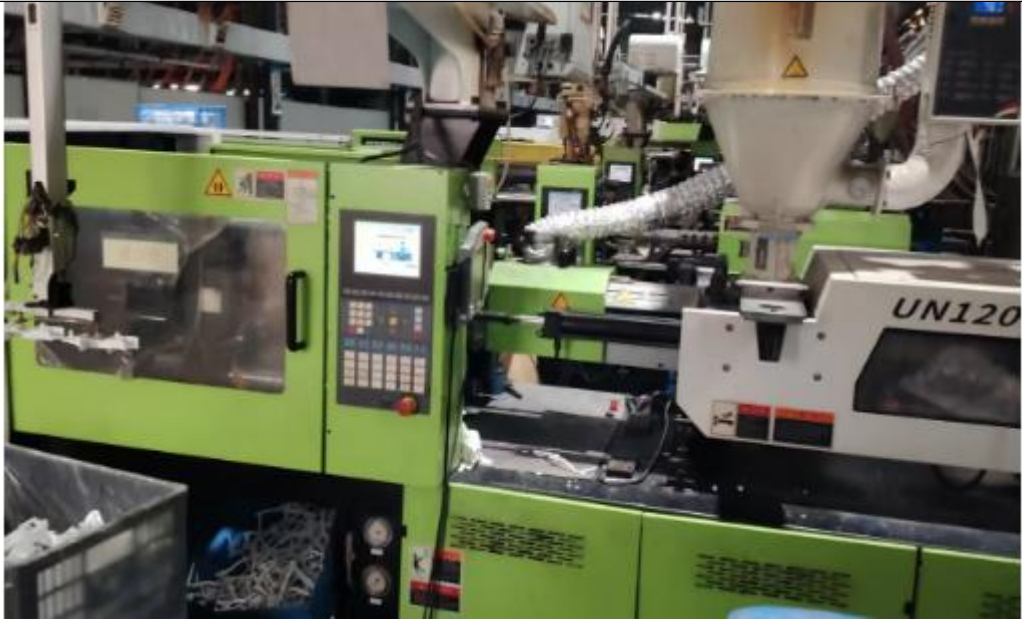
现有项目注塑废气收集设施
