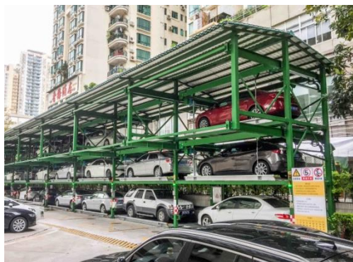
机械式立体停车库
